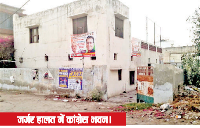
जर्जर हालत में कांग्रेस भवन।
